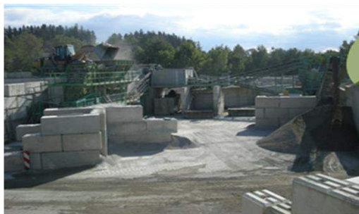
Installation de traitement de matériaux recyclés
