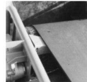
Figure 3: barre de protection en métal, au niveau du tambour moteur. Dans le cas des transporteurs avec mouvement réversible de la bande, la zone d'entraînement inférieure doit également être protégée.
