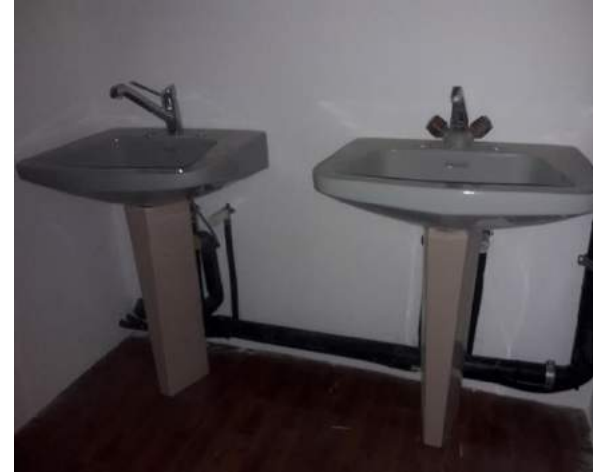
Installations provisoires sanitaires Chantier Rue de Bourg - Lausanne
