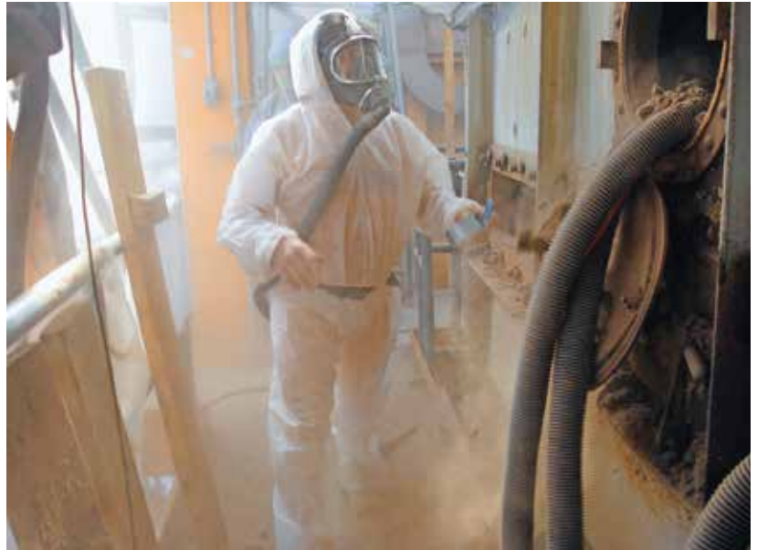
Asbesthaltige Isolation in Technikraum.
